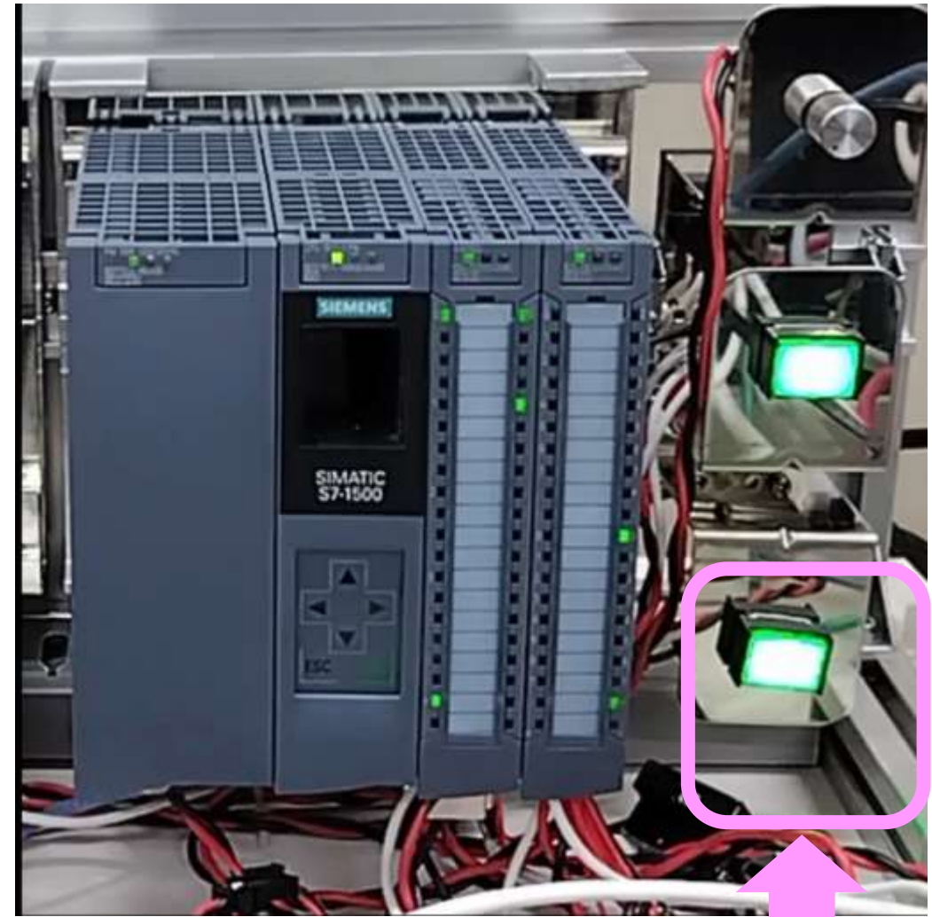
PLCの停止により表示が消灯
